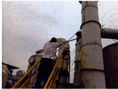
工业废气排放口 4# (FQ-6341023-4)
